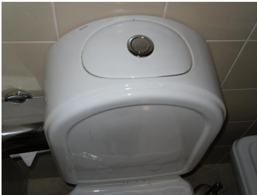
FOTO 1 - Cisterna cerâmica com autoclismo descarga completa
