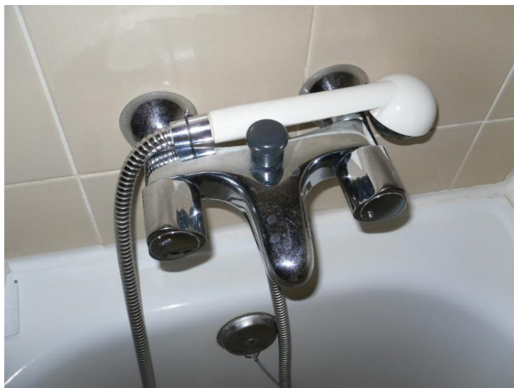
FOTO 3 – Sistema de duche
